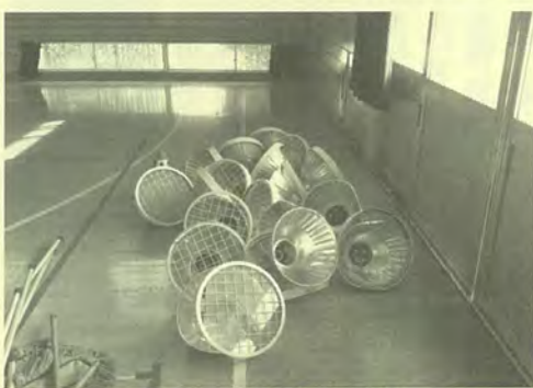
落下した体育館の照明
