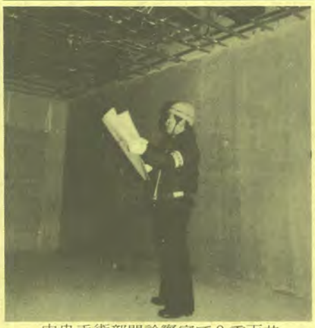
中央手術部門診察室で2重天井内の配管をチェックする椎野氏
